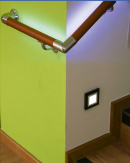
Beleuchteter Handlauf und Orientierungslicht
