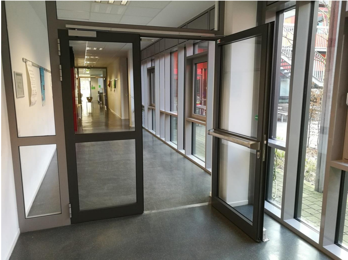
Abbildung 10 - Brandschutztür mit Feststelleinrichtung (schließt im Brandfall automatisch)
