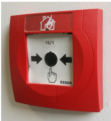
Abbildung 6 - Druckknopfmelder Hausalarm und Alarmierung Feuerwehr
