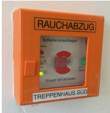
Abbildung 11 - Druckknopf Rauchabzug mit Beschriftung der Lage des Rauchabzuges
