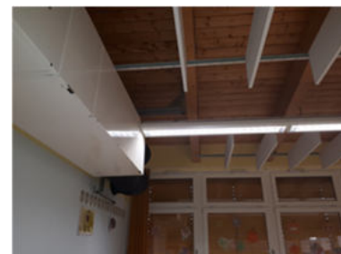
Lüftungsgerät Eiche-Schule Ober-Ramstadt
