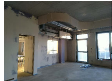
Klassenraum - Blick auf dezentrale Lüftung und Tür/Blickfenster zu Differenzierungsräumen
