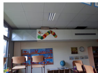
Lüftungsgerät, Heuneburgschule Fischbachtal
