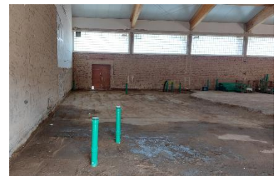
Verlegte Installation Sporthalle
