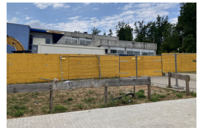
Abgesperrter ehemaliger Eingangsbereich Hauptgebäude (Blickrichtung Südwesten)
